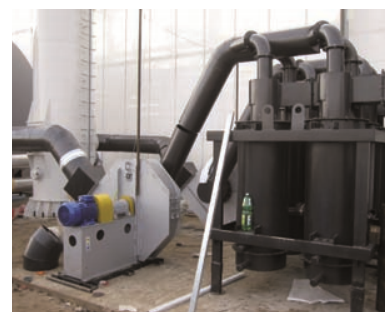
Fot. 2. Bateria cyklonów w kociołowni w firmie VOLMARY Sp. z o.o.
